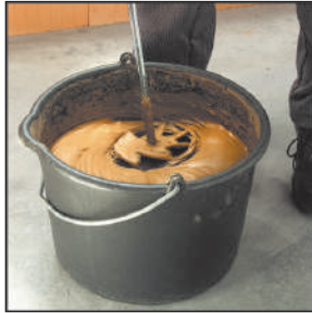
Der Dünnbettmörtel wird mit Wasser und dem Quirl angerührt und dann zur Verarbeitung in eine Mörtelwanne gefüllt.
